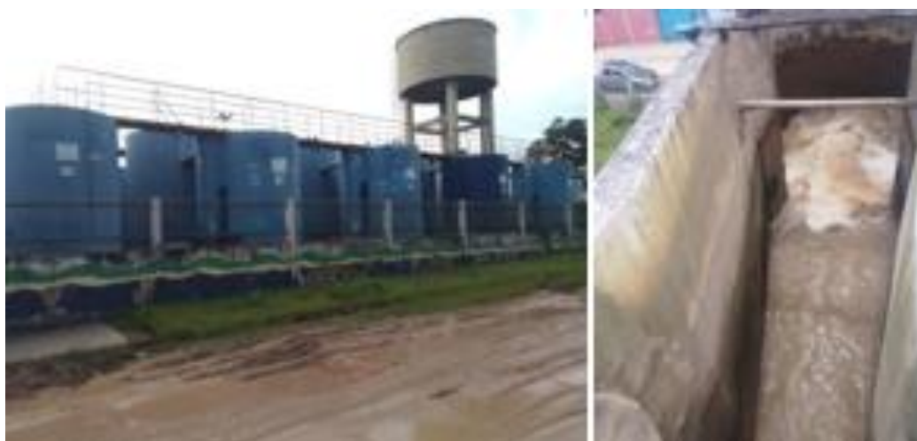
Figura 27- Companhia de Saneamento do Amazonas -COSAMA- Estação de Tratamento de Água
