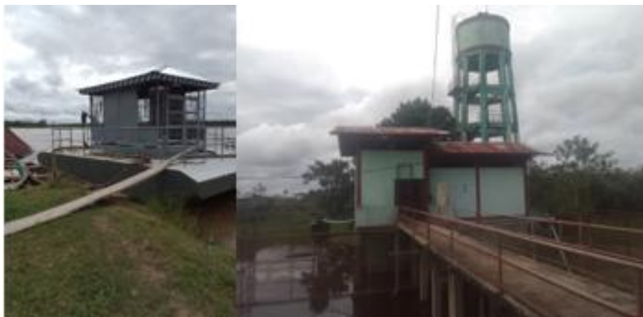
Figura 16- Balsa de Coleta e Estação de Tratamento de Água para abastecimento
