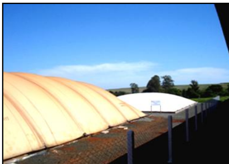
Figura 40 - Biodigestores 1 e 2 implantados em série na UGC.
