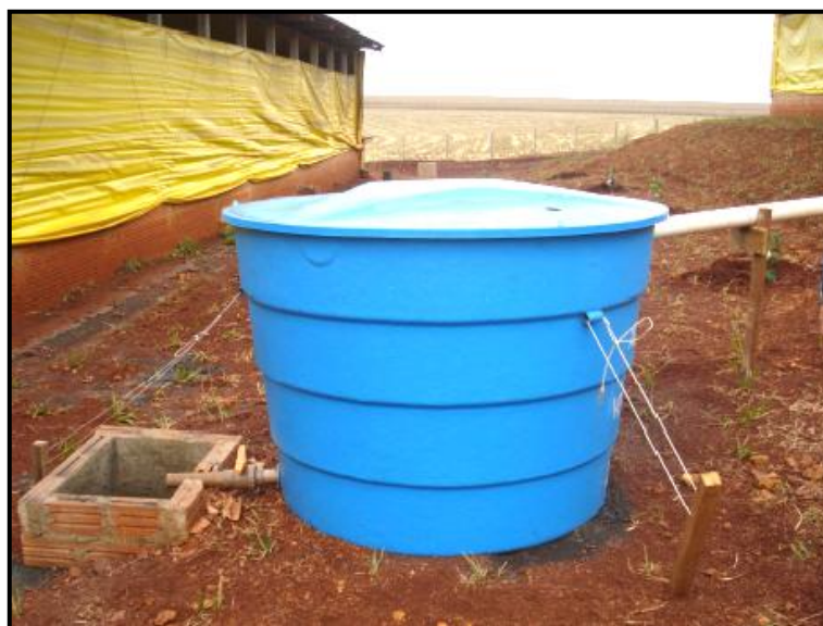
Figura 21 - Sistema de medição de vazão de efluentes na UGC.
