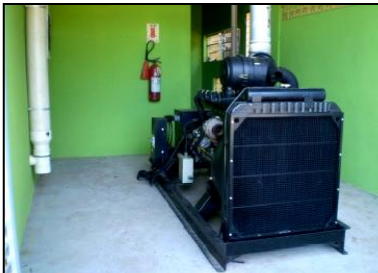
Figura 61 - Motor gerador de 100 kVA a biogás instalado na UGC.
