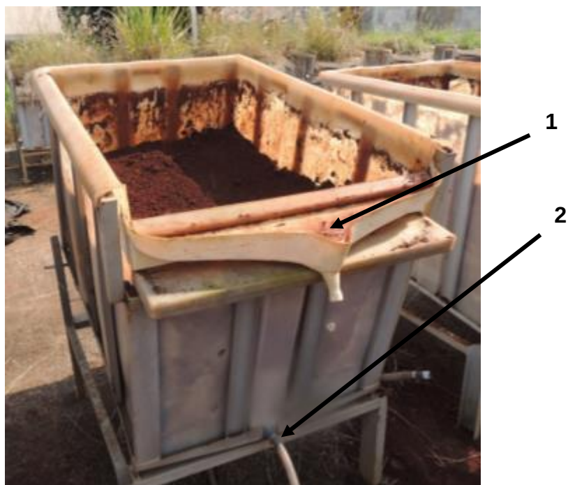
Figura 11. Caixa coletora sem tratamento na superfície. Fonte: Própria
