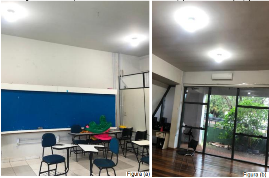
Figura 12 - Lâmpadas de LED - Sala de aula (a), Sala de dança (b)
