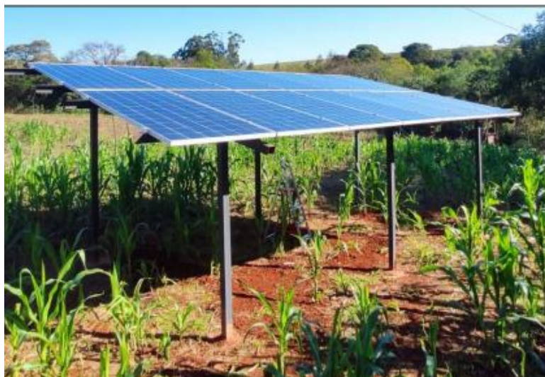
Figura 8. Sistema fotovoltaico instalado na comunidade
