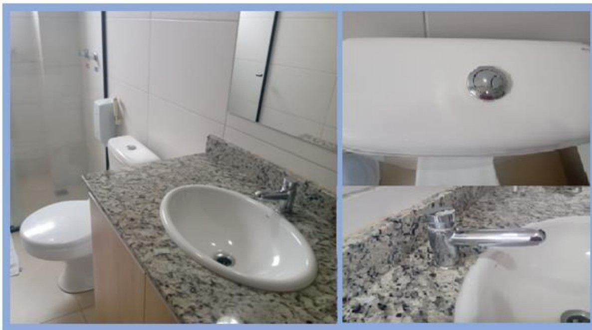
Figura 8. Evidência nos banheiros de torneiras com temporizador e descargas com duplo acionamento
