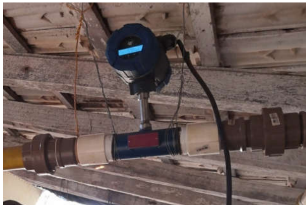
Figura 18. Medidor de vazão do biogás
