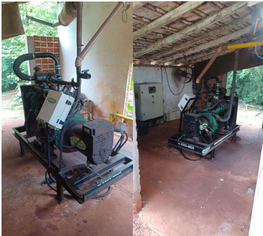
Figura 13. Grupo motor gerador A.
