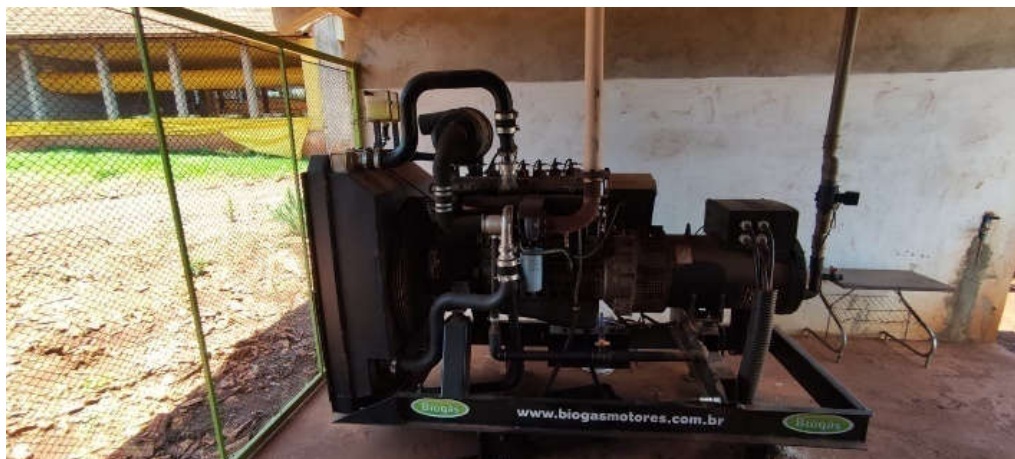
Figura 16. Grupo motor gerador D
