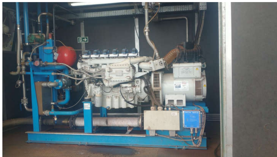
Figura 14. Grupo motor gerador B
