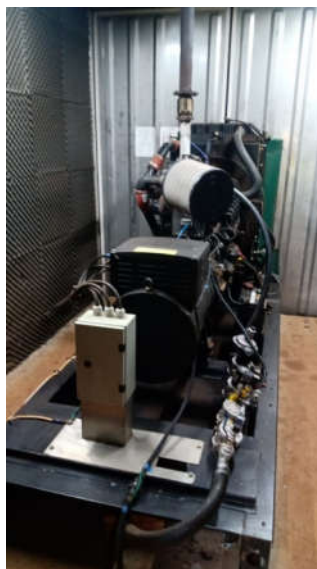
Figura 15. Grupo motor gerador C
