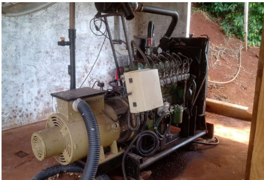
Figura 17. Grupo motor gerador E
