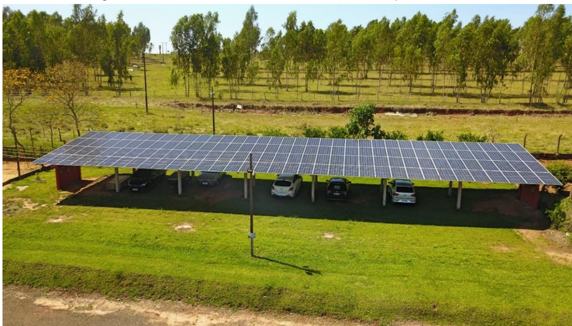
Figura 4.4 – Vista do sistema fotovoltaico de médio porte do Caso 2
