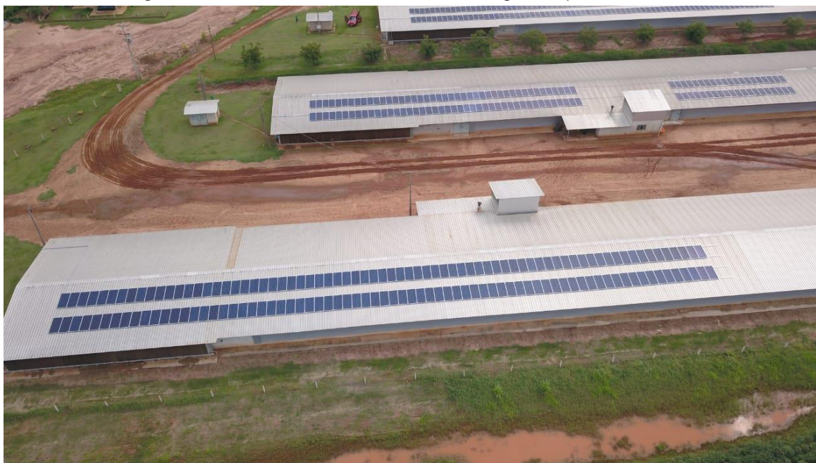
Figura 4.5 – Vista do sistema fotovoltaico de grande porte do Caso 3
