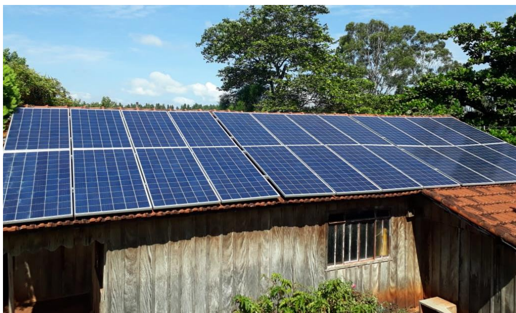
Figura 4.3 - Vista do sistema fotovoltaico de pequeno porte do Caso 1
