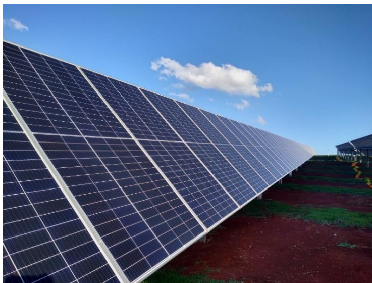
Figura 17 - Módulos fotovoltaico Risen Solar Technology – RSM150-8-500M. Fonte: A própria autora.
