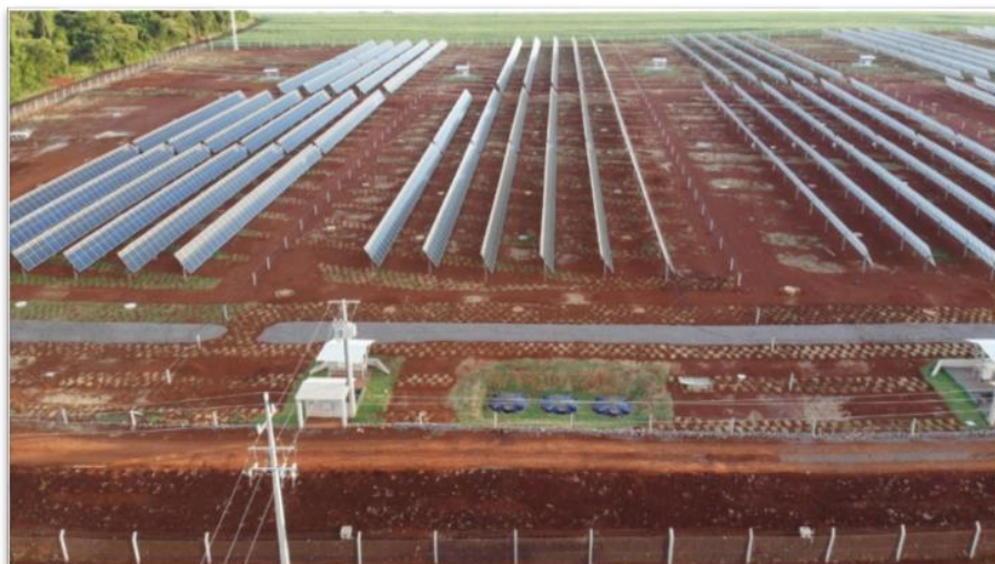
Figura19 - Minigeração fotovoltaica Usina Olímpio de 2,2 MW localizado na cidade de Cascavel – PR.
