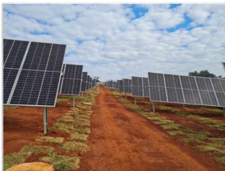
Figura 20 - Minigeração fotovoltaica Usina Olímpio de 2,2 MW localizado na cidade de Cascavel – PR.
