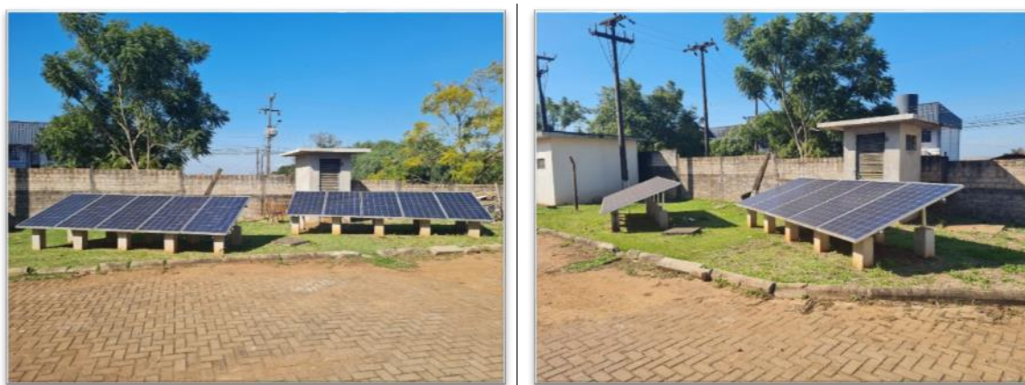
Figura 17 - Microgeração fotovoltaica pertencente ao sistema do projeto CASA – Campus Cascavel – UNIOESTE.
