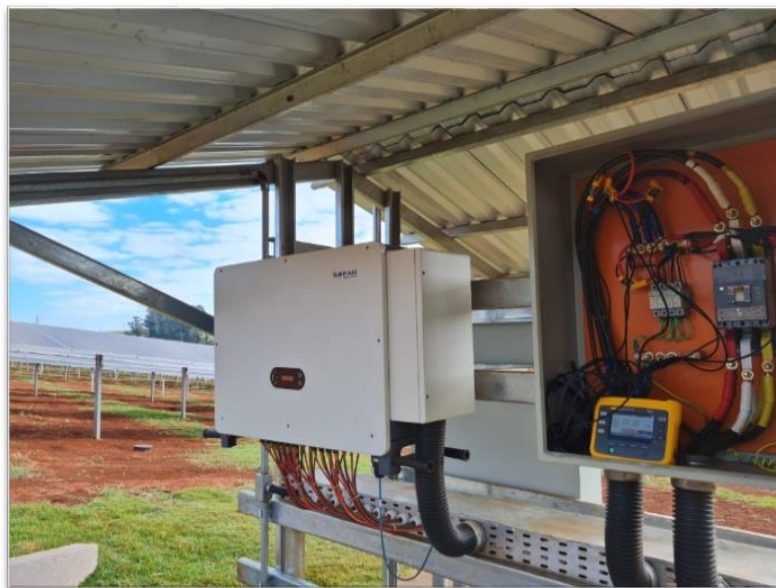
Figura 21 – Ponto de coleta dos dados do inversor de 100 kW da usina Olímpio. Fonte: Autora
