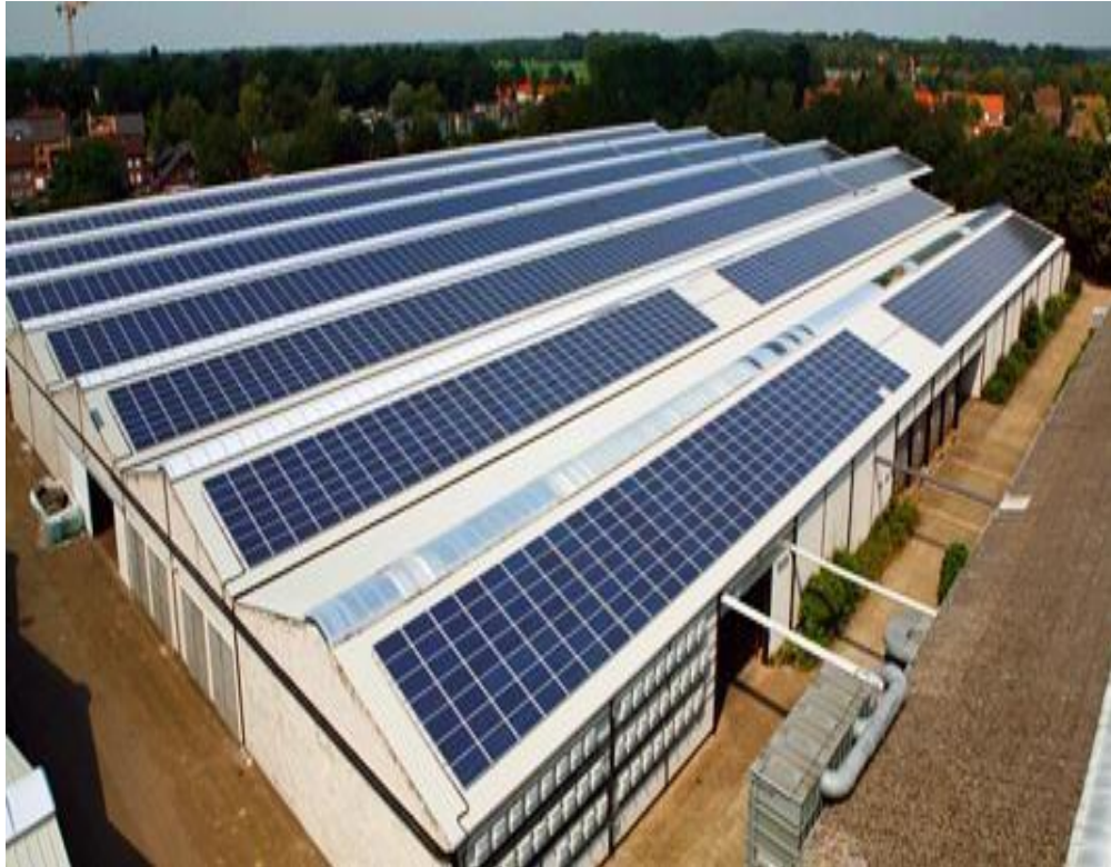
Figura 8 Sistema com células fotovoltaicas no telhado de aviário.
