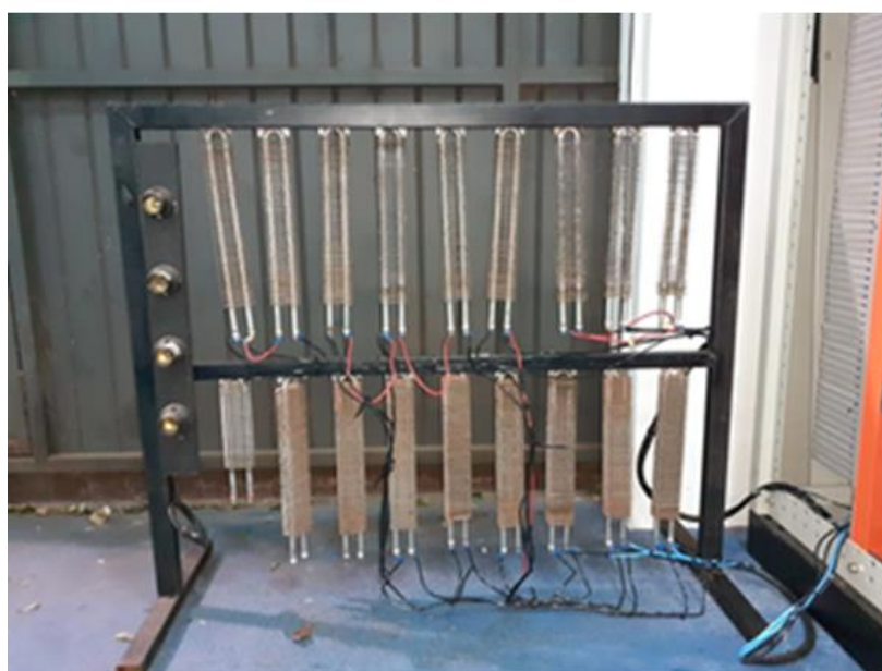
a) Banco de resistências
