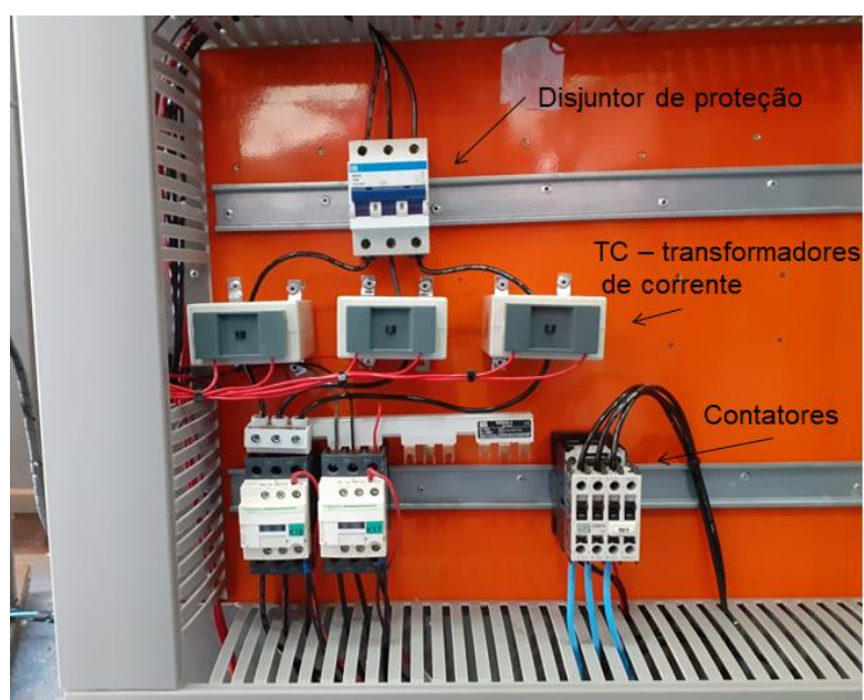
Figura 25. Componentes elétricos de comando, proteção, acionamento e medição.
