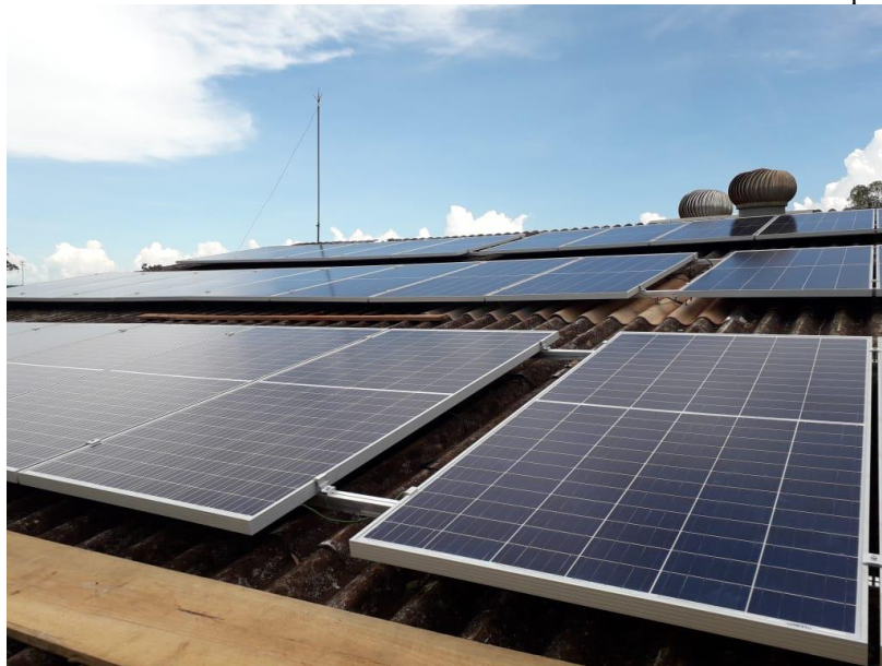
Figura 18 - Módulos Fotovoltaicos da Unidade Geradora 1. Fonte: Autoria própria.
