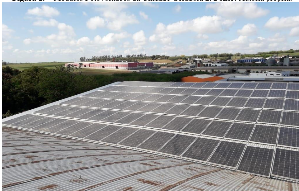
Figura 19 - Módulos Fotovoltaicos da Unidade Geradora 2. Fonte: Autoria própria.
