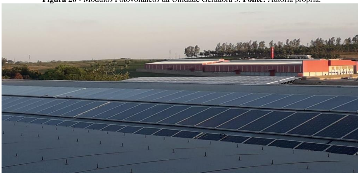
Figura 20 - Módulos Fotovoltaicos da Unidade Geradora 3. Fonte: Autoria própria.
