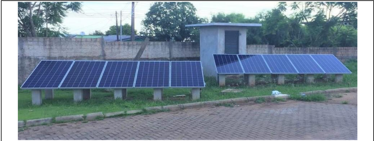
Figura 21: Sistema de geração fotovoltaico. Fonte: Autoria própria, 2020.
