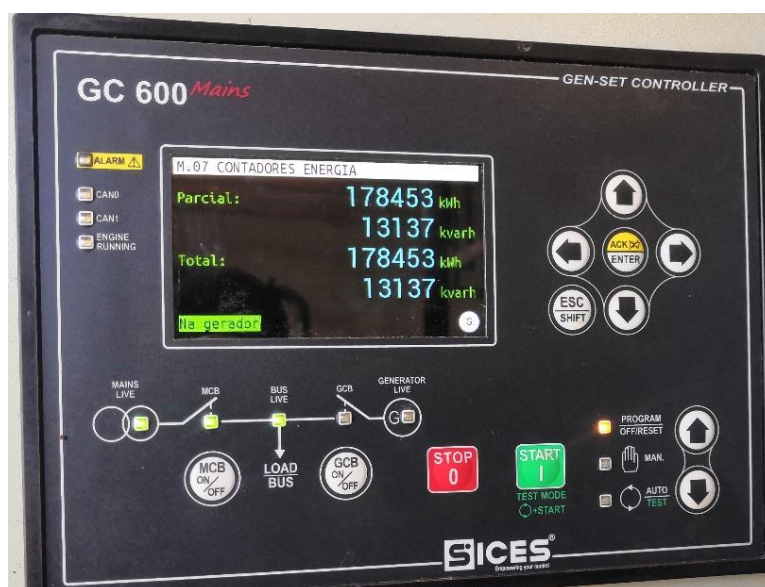
Figura 11 – Controlador do painel de comando do grupo gerador Fonte: A autora.
