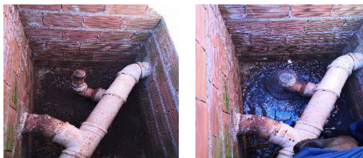
Figura 6 - Sistema de remoção de água do biogás
