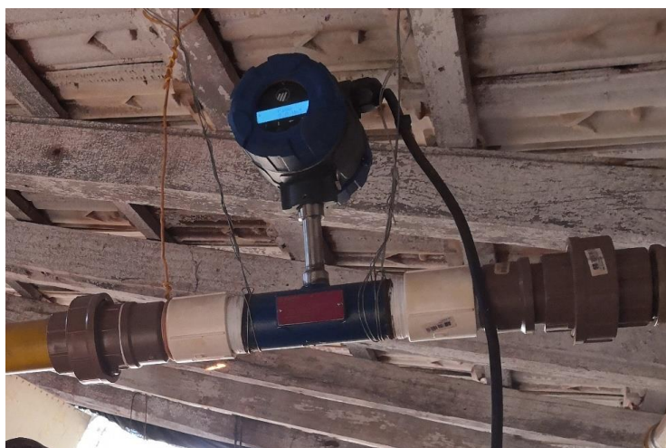
Figura 10 - Medidor de vazão do biogás
