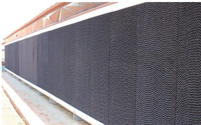
Figura 20- Pad Cooling Fonte: Philips, 2020.
