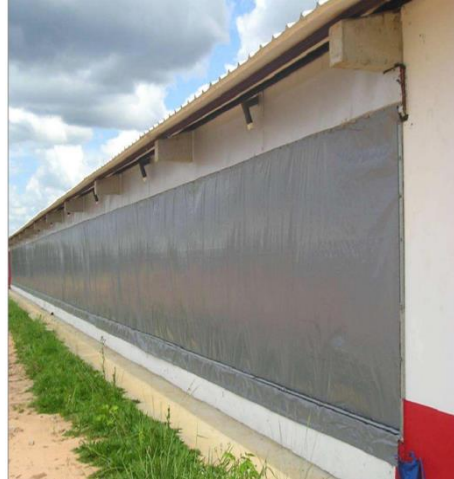
Figura 18 - Cortinas em polietileno Fonte: Troni, 2015.
