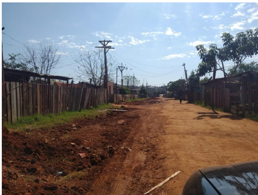
Figura 1: Falta de pavimentação asfáltica
