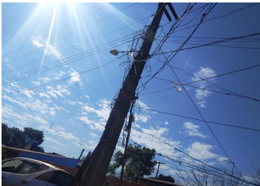
Figura 3: Ligações clandestinas para energia elétrica
