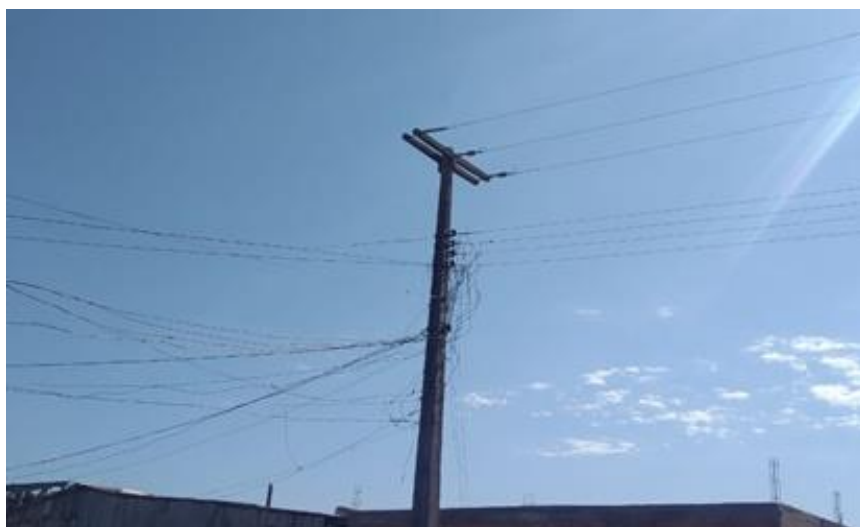
Figura 4: Ligações clandestinas de energia elétrica
