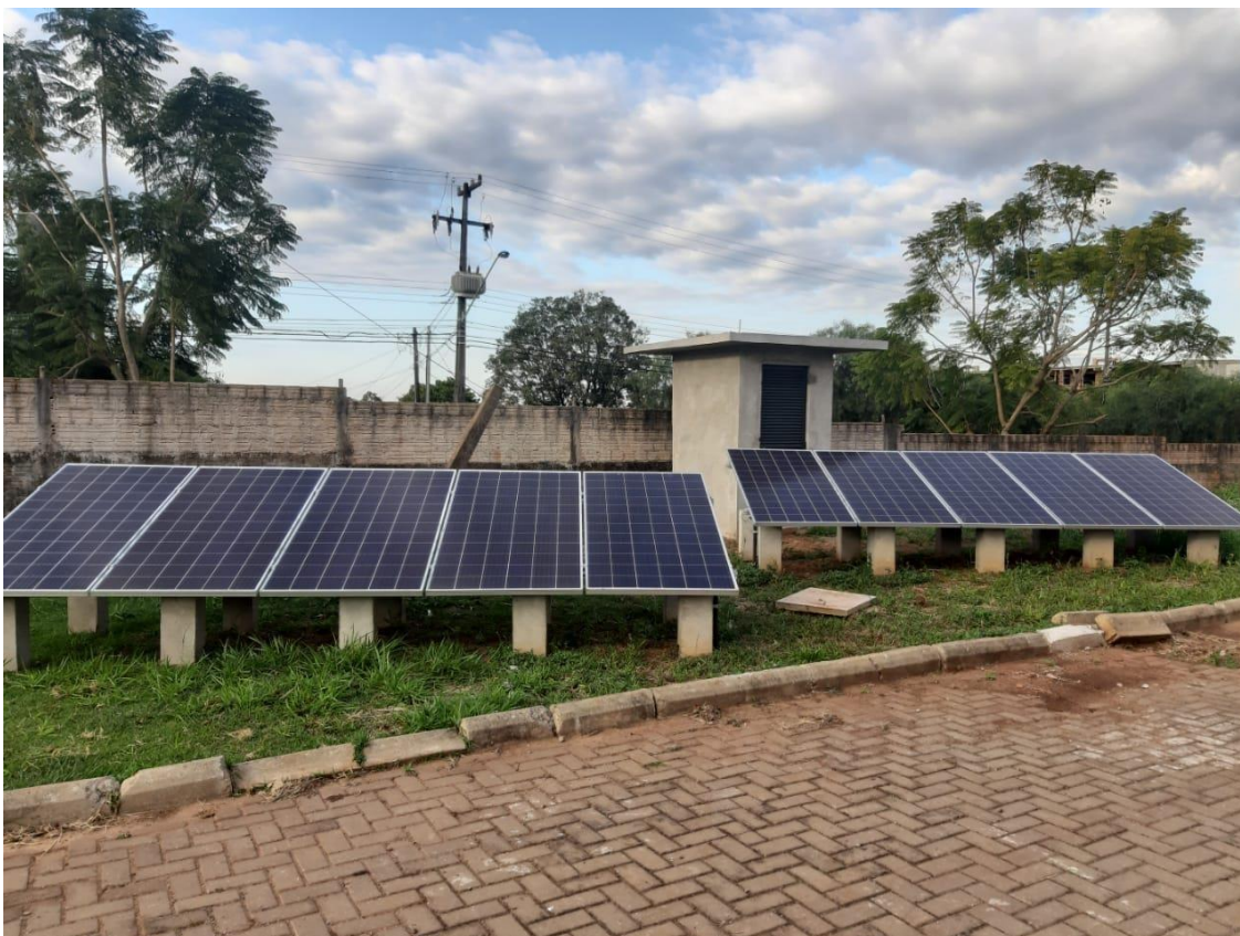
Figura 16 – Sistema fotovoltaico instalado na Unioeste.
