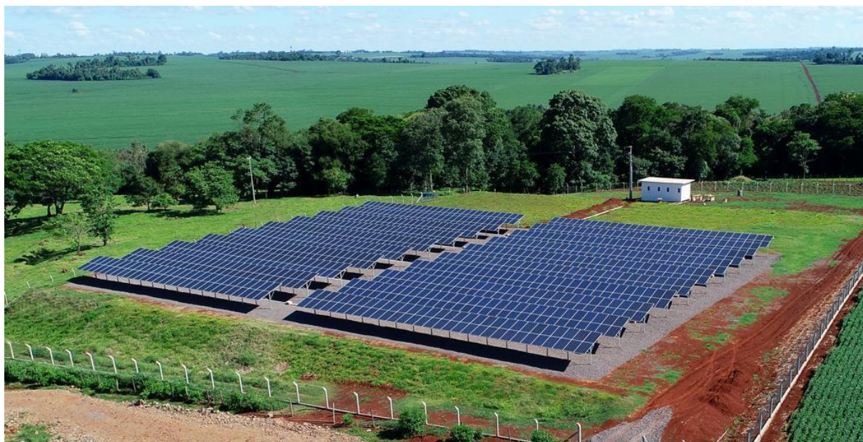
Figura 11 – Usina Fotovoltaica instalada na propriedade. Fonte: (AUTOR, 2019)
