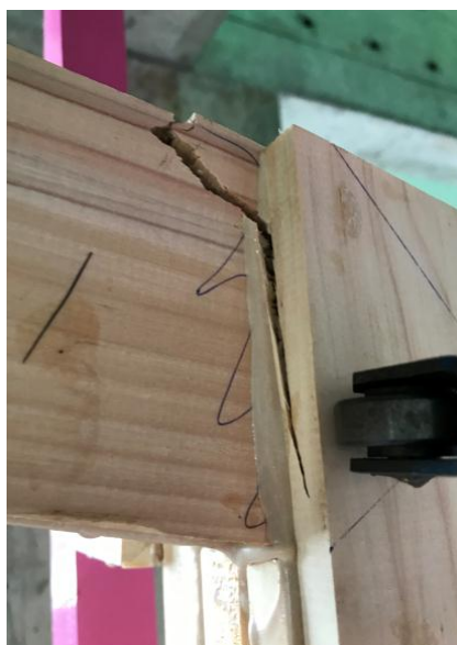
Figura 21 – Detalhe de ruptura do pórtico 4, nó E.
