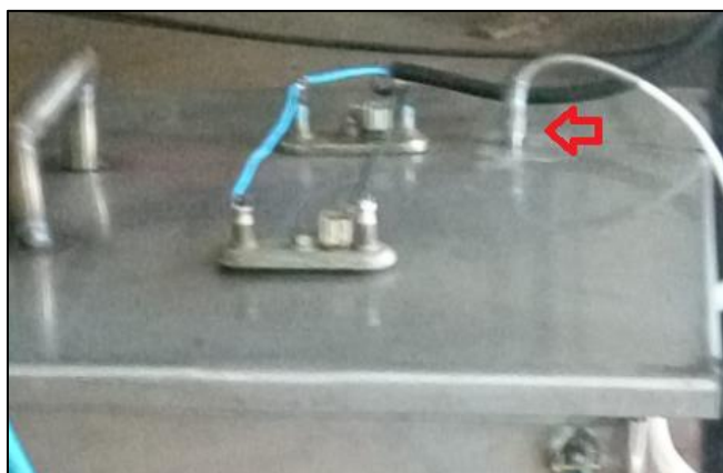
Figura 27. Sensor PT 100 instalado na tampa do reservatório. Fonte: Arquivo do autor (2019).
