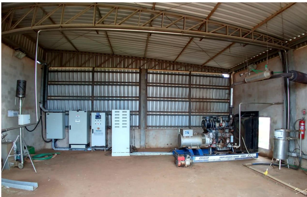
Figura 10: Imagem ilustrativa da situação do recinto de geração na Fazenda Iguaçu no dia 25 de setembro, onde pode-se visualizar uniade geradora de 330 kVA e painéis de proteção.
