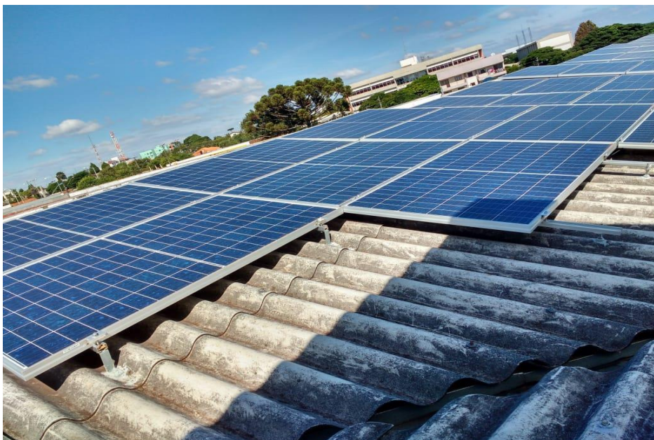
Figura 11 - Sombreamento em módulo fotovoltaico instalado em telhado.
