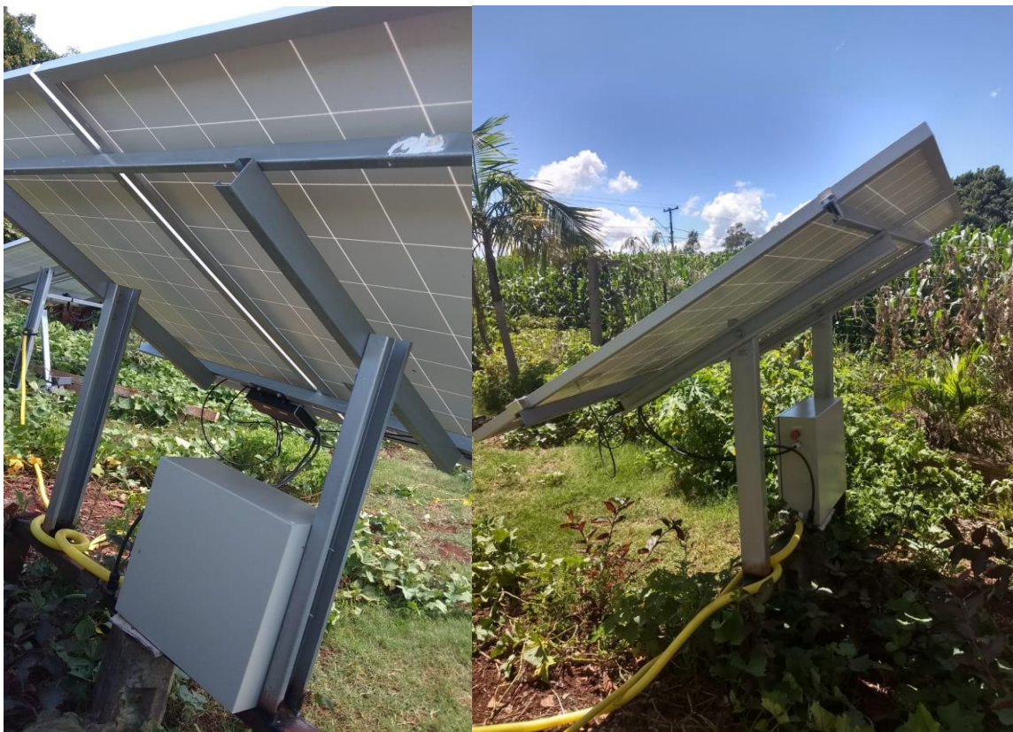
Figura 33 - Fixação dos Painéis Fotovoltaicos na Estrutura Fixa.
