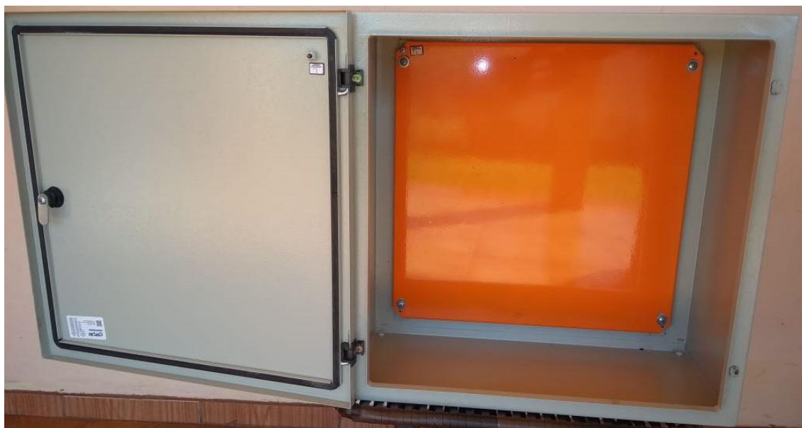
Figura 27– Quadro Elétrico de Comando e de Força, fabricante Opção Painéis.
