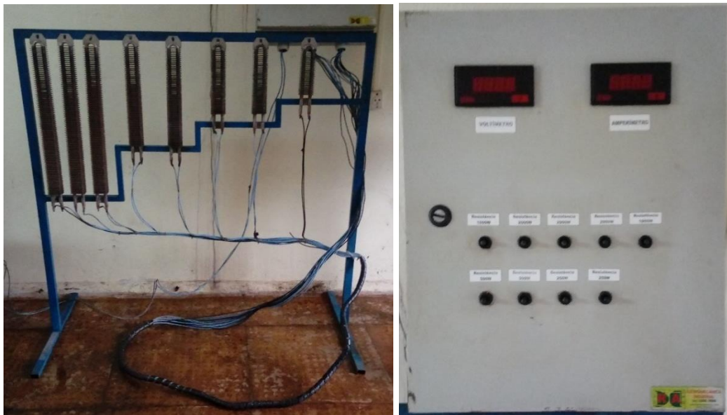
Figura 13 Banco de Cargas Resistivas
