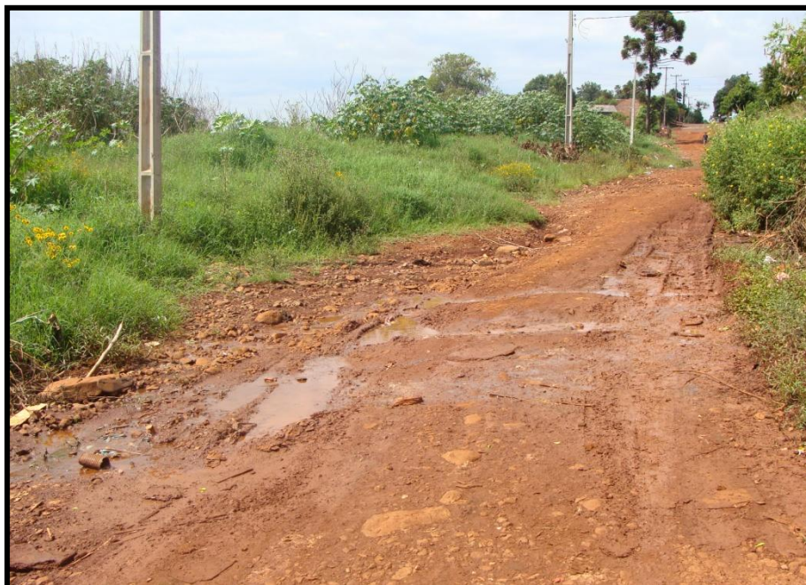
Figura 49 - Falta de Infra-Estrutura Básica no Território Interlagos
