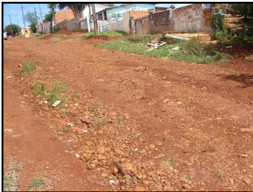
Figura 51 - Falta de Estrutura Asfáltica
