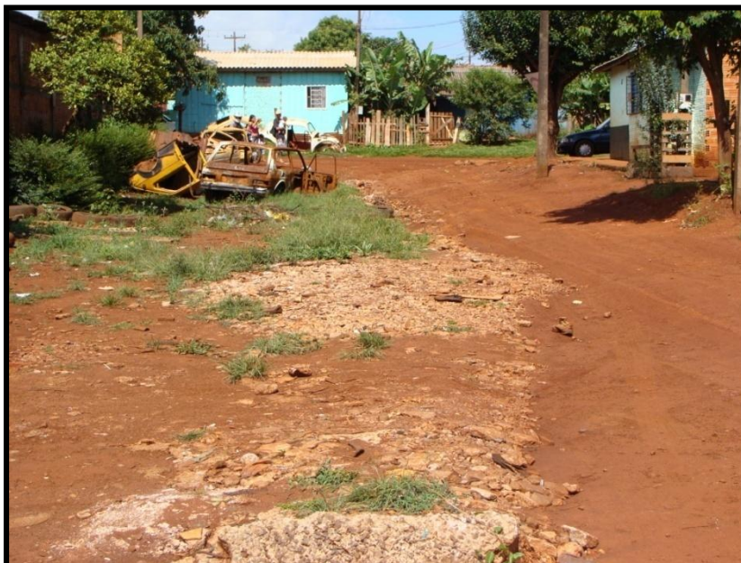
Figura 52 - Falta de Estrutura Asfáltica
