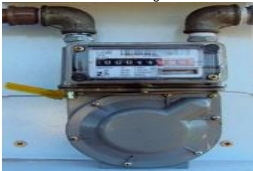
FIGURA 14 – Medidor de gás.
