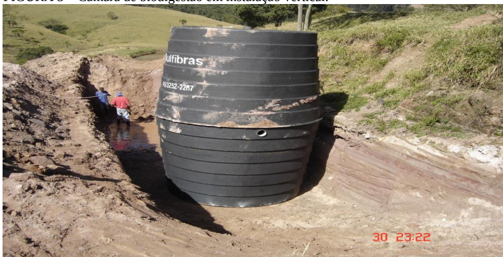
FIGURA 3 – Câmara de biodigestão em instalação vertical.
