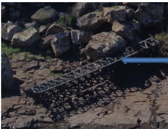
Figura 50: Estrutura de metal que fazia parte da Plataforma de rapel(BR), destruída na cheia de 2014 (Foto da autora)
