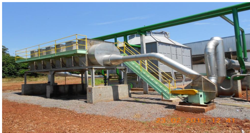
Figura 4.14 – Sistema de tratamento de resíduos gasosos desenvolvido pela UNIOESTE.
