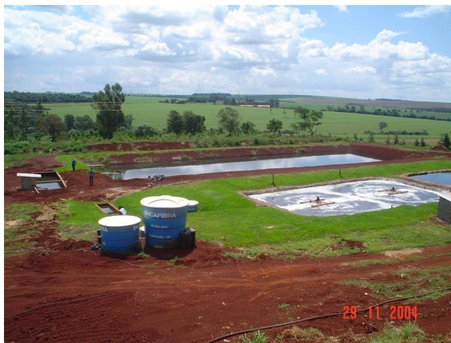
Figura 9 - Visão geral do sistema de tratamento de percolados.
