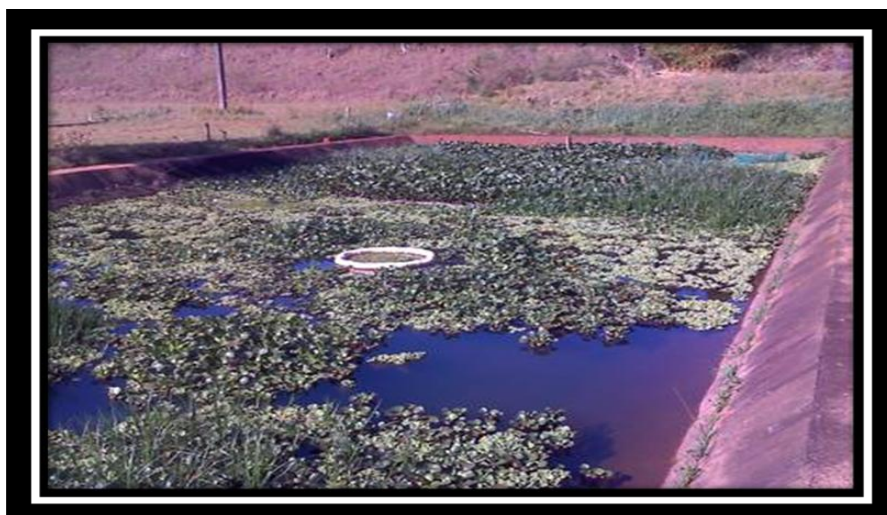
Figura. 5 – Macrófitas aquáticas dispostas em tanque escavado.
