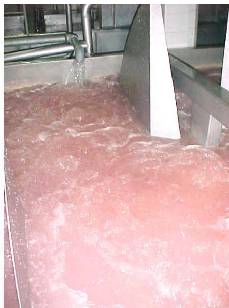
Figura 07 – Chiller com agitação por borbulhamento de ar.
