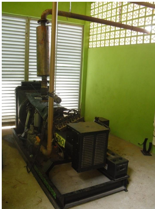
Figura 4.11- Gerador de 100 kVA - Financiamento da Finep.
