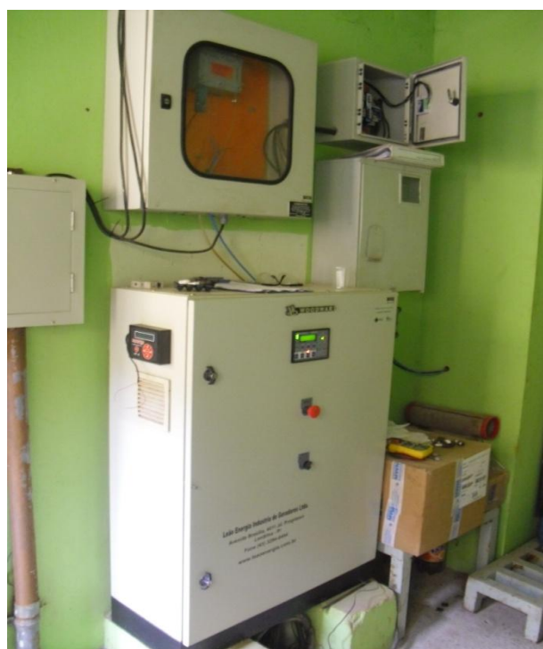
Figura 4. 12 - Painei SMCP (Sistema de Proteção Monitoramento e Controle) –Woodward.
