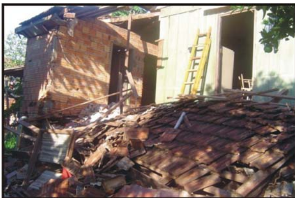
FOTO 26: Desmoronamento da casa da Sirlei Francisco dos Santos Fonte: Valdemir José Sonda, 24 dez. 2005
