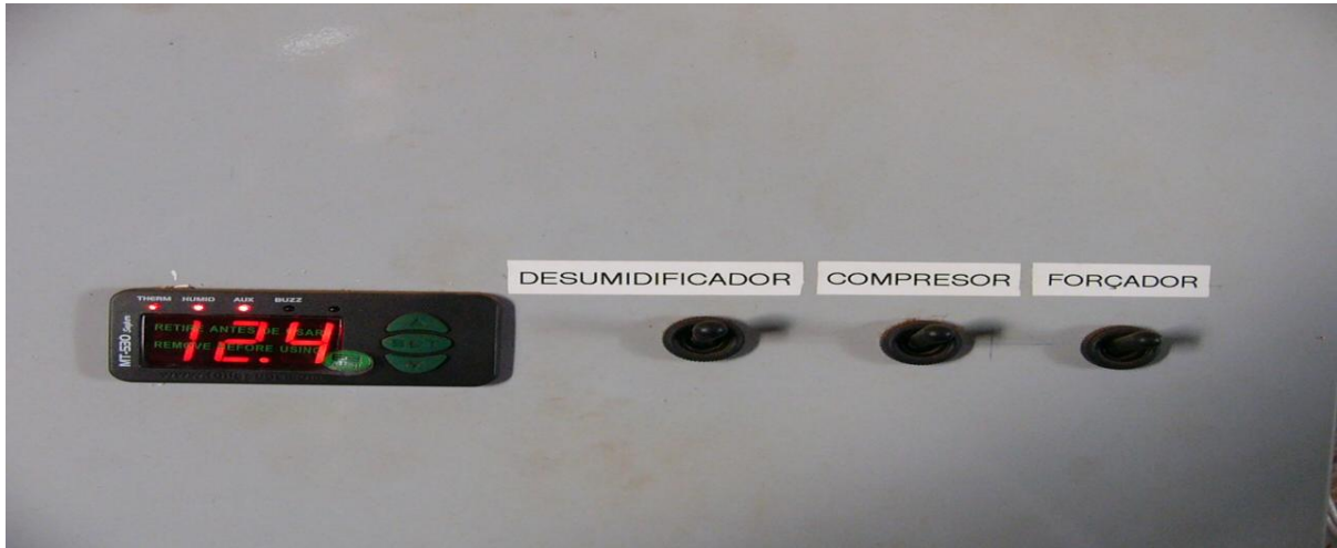
Painel de controle na parte externa da câmara de resfriamento
