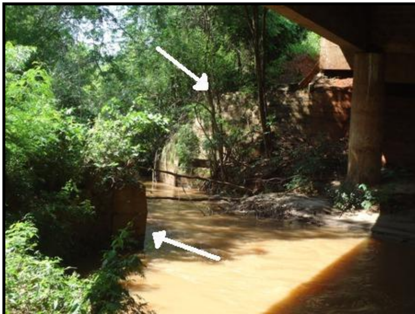
FIGURA 15 – Barreiras de proteção em ambas as margens a montante da ponte sobre o rio Taturí, sendo indicadas pelas setas brancas (Ponto 1), BR 163 (Foto: Leandro Neri Bortoluzzi, data: 27/10/2011).
