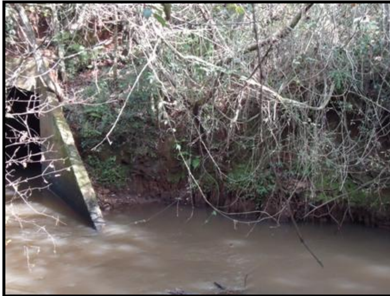
FIGURA 26 – Migração lateral na margem direita do canal a montante do bueiro celular de concreto no rio Guaçu (Ponto 16), PR 182 (Foto: Leandro Neri Bortoluzzi, data: 02/06/2011).
