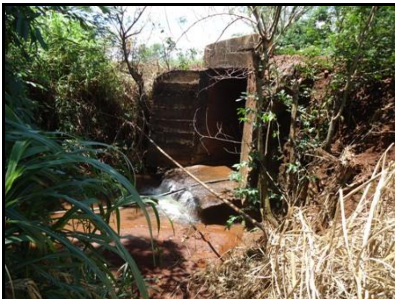
FIGURA 27 – Erosão em ambas as margens e no leito a jusante do bueiro celular de concreto, córrego Mirim (Ponto 21), rodovia municipal de Marechal Cândido Rondon (Foto: Leandro Neri Bortoluzzi, data: 27/10/2011).
