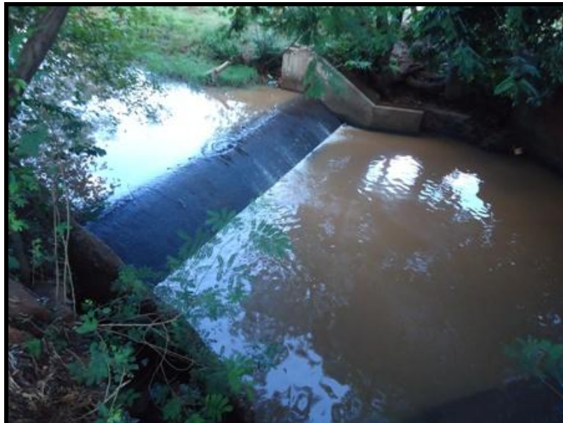
FIGURA 24 – Represa inutilizada a montante do bueiro celular de concreto no rio Leão (Ponto 45), PR 497 (Foto: Leandro Neri Bortoluzzi, data: 18/01/2012).
