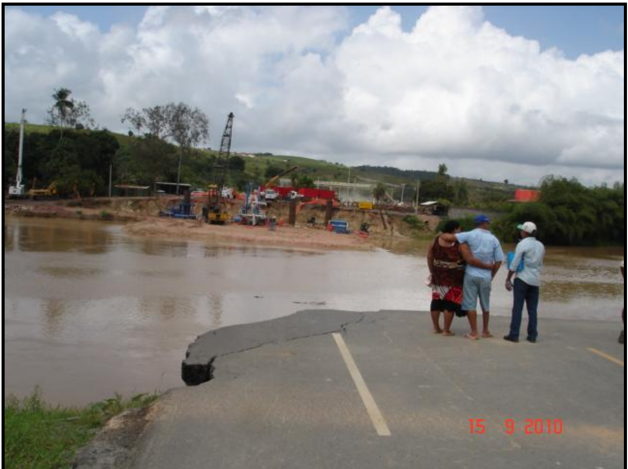
FIGURA 1- Destruição total de ponte na cidade de Palmares (PE) (Foto: Oscar Vicente Quinonez Fernandez, data: junho de 2010).
