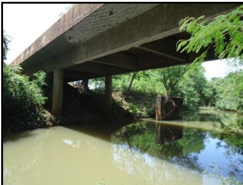
FIGURA 21 – Vista da jusante em direção a ponte no rio São Vicente (Ponto 39), PR 495, canal com nível excelente de estabilidade (Foto: Leandro Neri Bortoluzzi, data: 06/10/2011).
