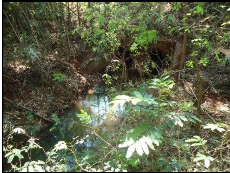
FIGURA 20 – Assoreamento a montante do bueiro tubular de concreto no rio Moreirão (Ponto 37), PR 495 (Foto: Leandro Neri Bortoluzzi, data 06/10/2011).
