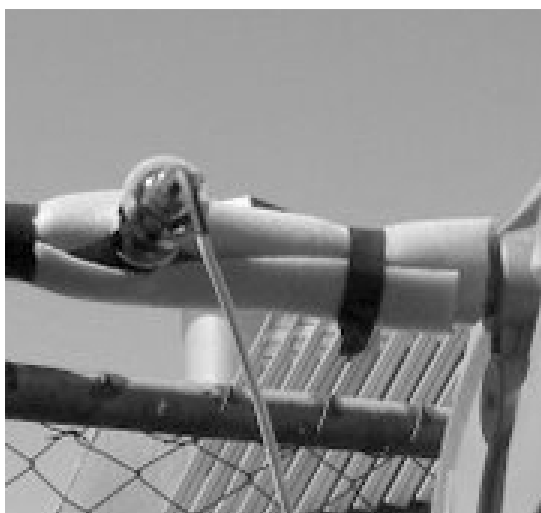
FIGURA 12 – Sensor 5, instalado na tubulação de saída de água quente.
