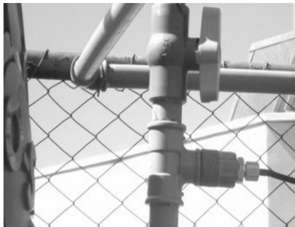
FIGURA 8 – Sensor 1, instalado na tubulação de entrada de água fria.
