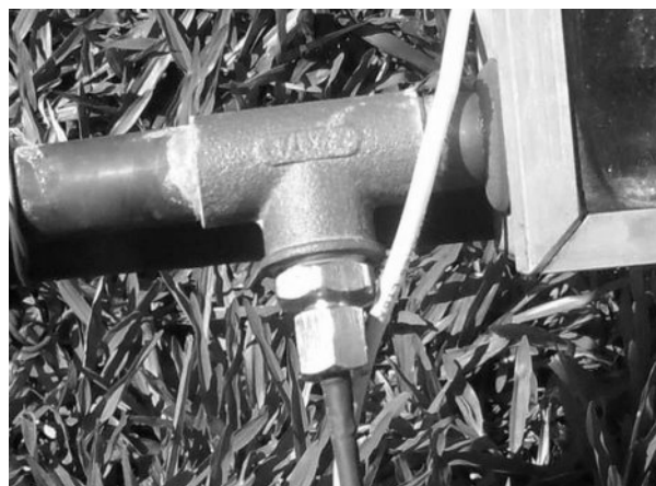
FIGURA 9 – Sensor 2, instalado na tubulação de entrada do coletor solar.
