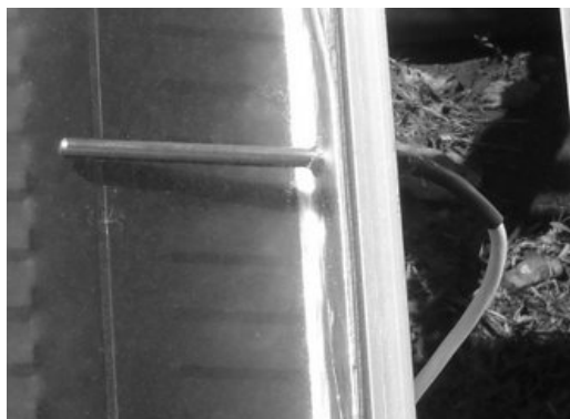
FIGURA 13 – Sensor 6, instalado na placa de absorção dentro do coletor solar.
