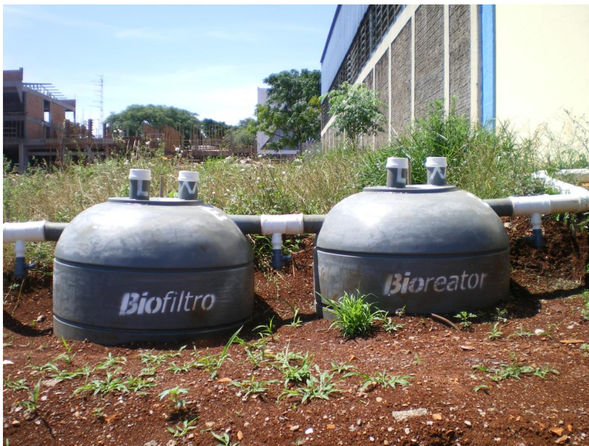
Figura 13. Sistema de Tratamento Biológico Bioreator seguido do Biofiltro
