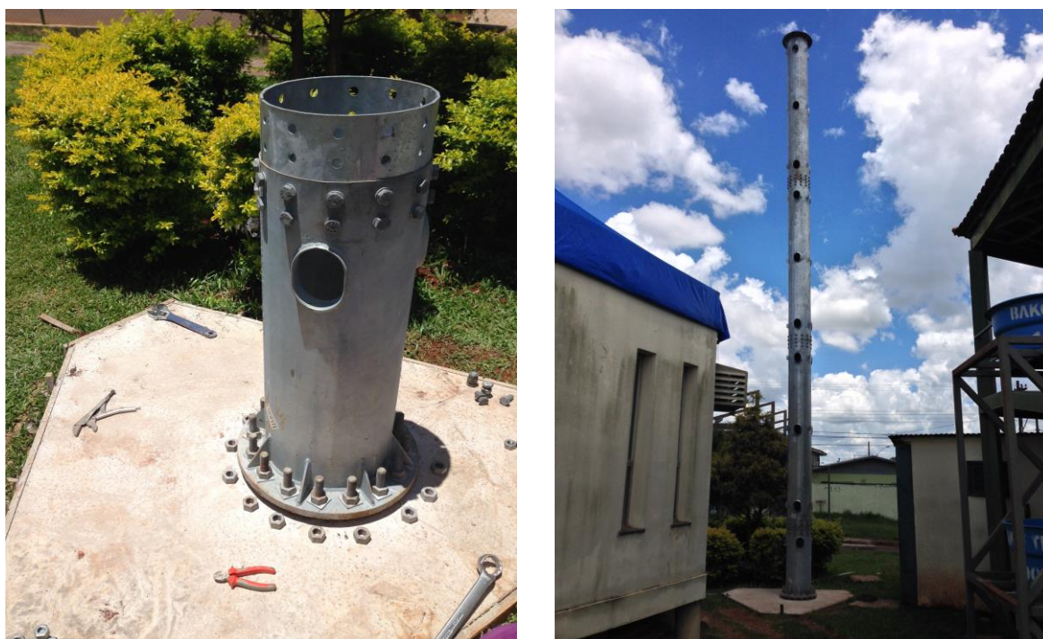
Figura 11: Torre e base de fixação.
