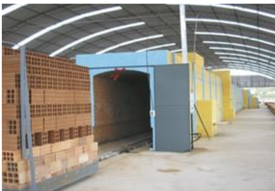
Figura 5 - Forno túnel Fonte: Souza (2020).
