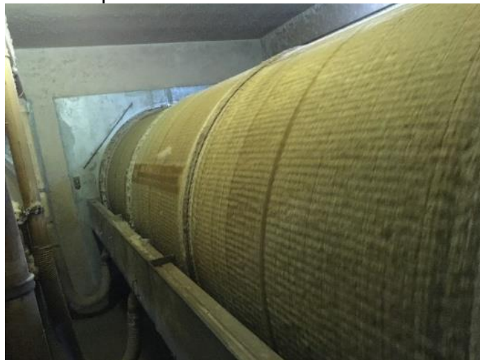
Figura 24. Modelo de Depurador Instalado em ambiente industrial.
