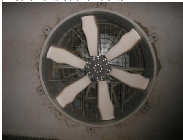
Figura 25. Pás de insuflamento de ar ambiente
