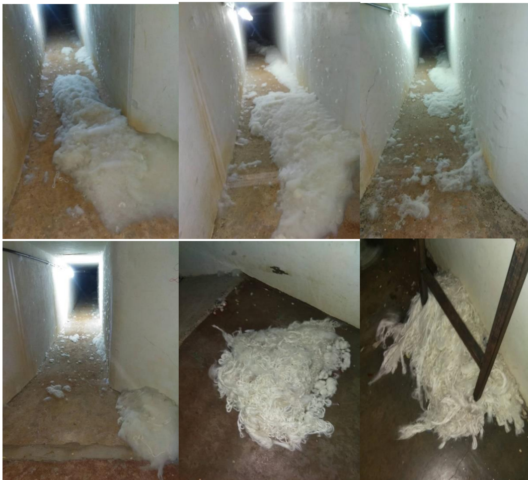
Figura 71. Túneis de sucção com resíduos.
