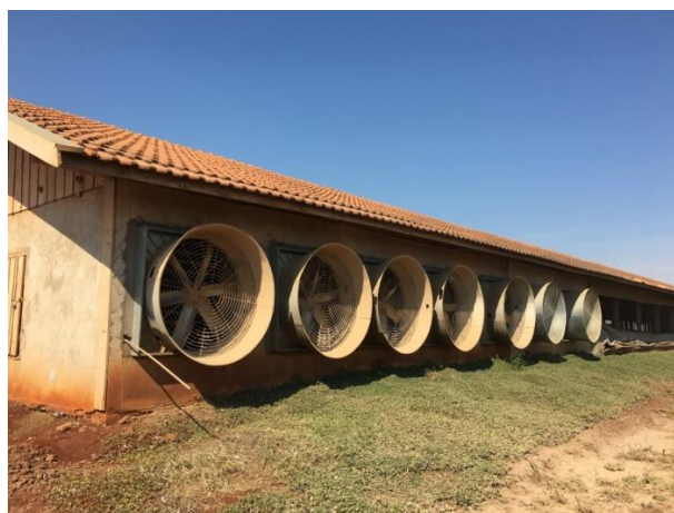
Figura 27: Sistema de ventilação – exaustores do aviário AV1.
