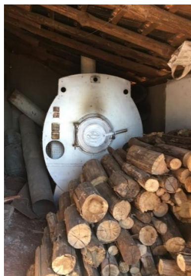
Figura 23: Sistema de aquecimento do aviário AV1 – forno a lenha.
