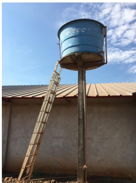
Figura 41: Sistema de abastecimento de água – reservatório com capacidade de 1.000 litros.
