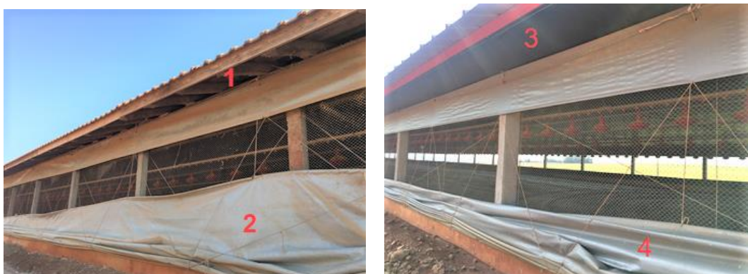
Figura 15: Beiral com estrutura em madeira (1) e cortina preta-prata do aviário AV1 (2). Beiral com estrutura metálica e forração em lona preta (3) e cortina preta-prata do aviário AV2 (4).
