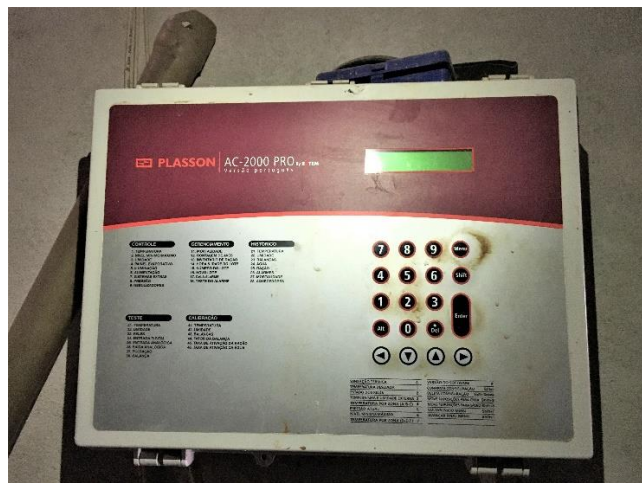
Figura 34: Sistema de controle – painel Plasson AC-2000 PRO.
