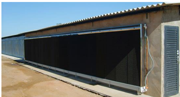
Figura 6: Painel evaporativo sistema pad cooling . Fonte: ICE HOUSE BRASIL, 2011.
