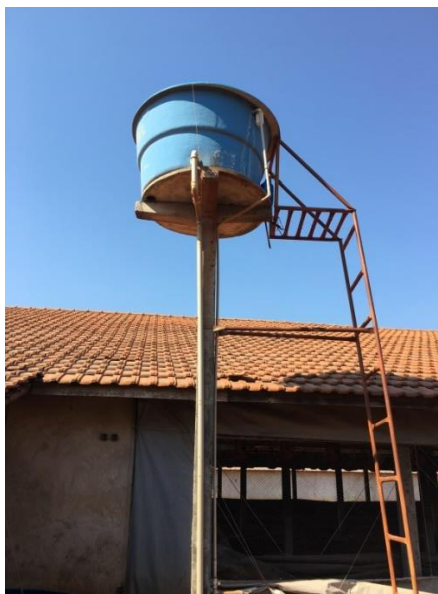
Figura 32: Sistema de abastecimento de água – reservatório com capacidade de 1.000 litros.
