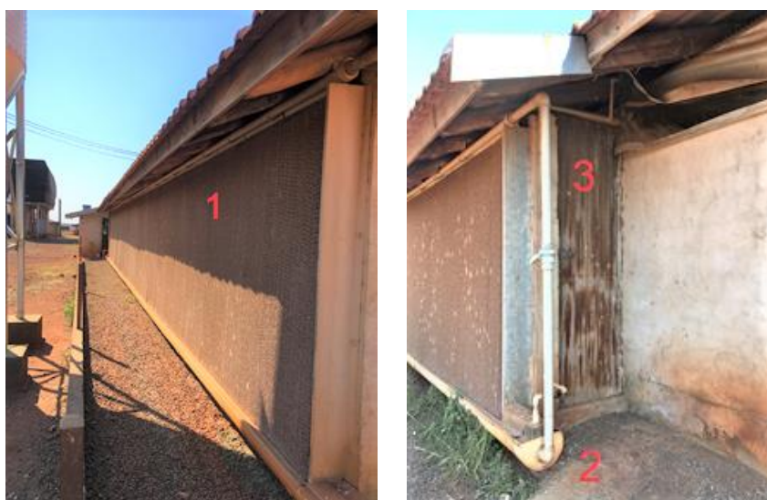
Figura 25: Sistema de resfriamento pad cooling – painéis evaporativos de celulose (1). Rede hidráulica do sistema pad cooling (2) e acesso à manutenção do sistema (3).
