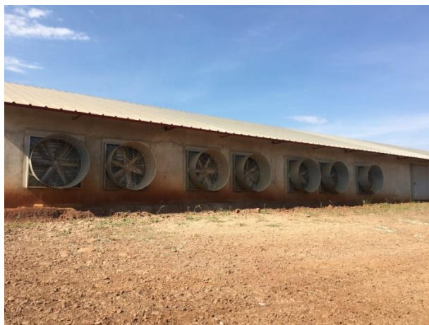
Figura 38: Sistema de ventilação – exaustores do aviário AV2.
