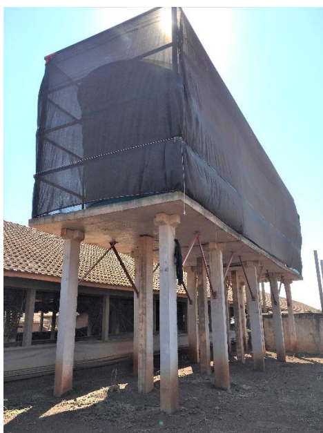
Figura 31: Sistema de abastecimento de água – reservatório com capacidade de 20.000 litros.
