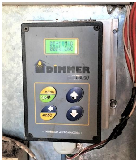
Figura 28: Sistema de iluminação – dimmer Inobram I-8000.
