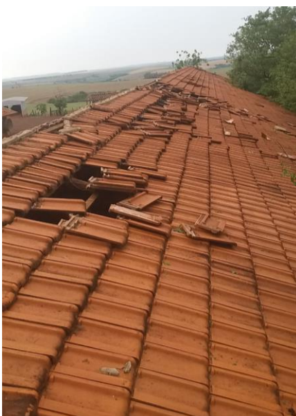
Figura 45: Cobertura do aviário AV1 após temporal.
