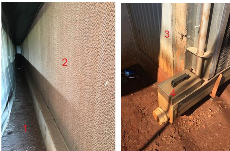
Figura 36: Duto de ar refrigerado (1) e painéis evaporativos de celulose, pad cooling (2). Acesso à manutenção do sistema pad cooling (3) e sistema de distribuição de água para os painéis evaporativos (4).
