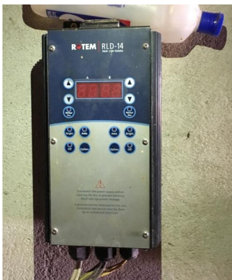
Figura 39: Sistema de iluminação – dimmer Rotem RLD-14.
