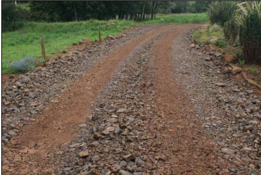
Figura 8 - Perda de Agregados
