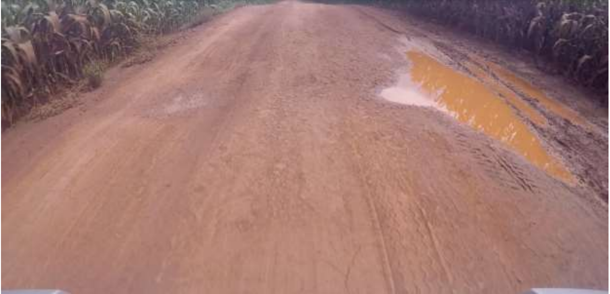
Figura 18 - Drenagem lateral inadequada
