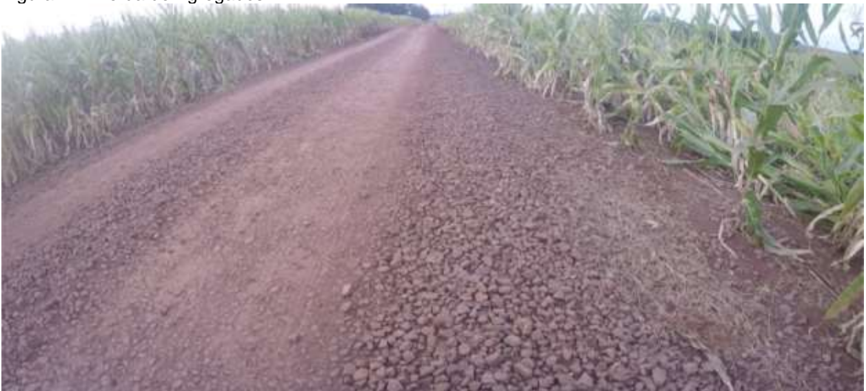
Figura 21 - Perda de Agregados
