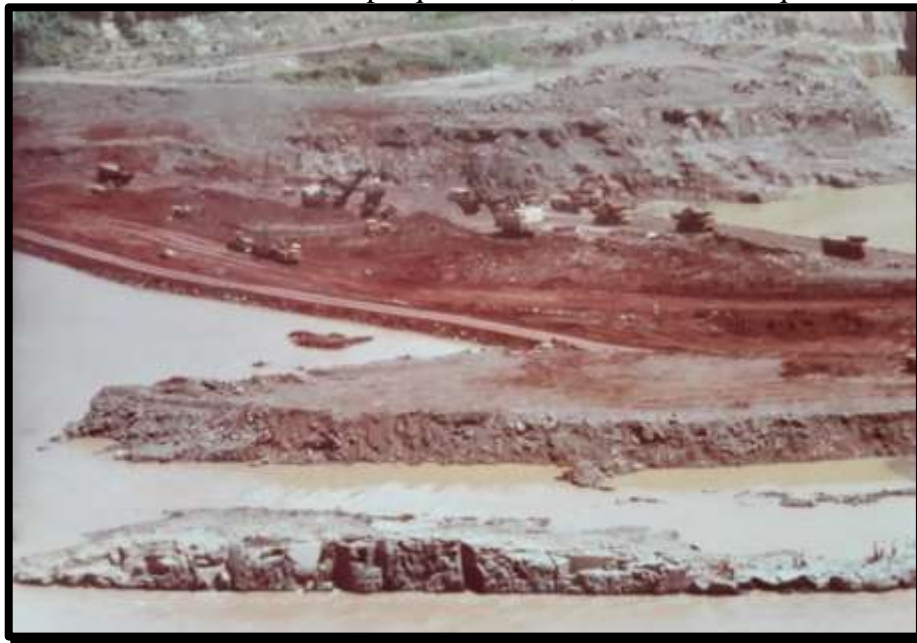
Figura 7. Vista aérea do início do parque de obras, com várias máquinas trabalhando
