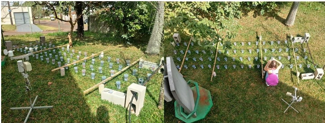
Figura 32. Sistema de irrigação por gotejamento implantado próximo do laboratório CASA.
