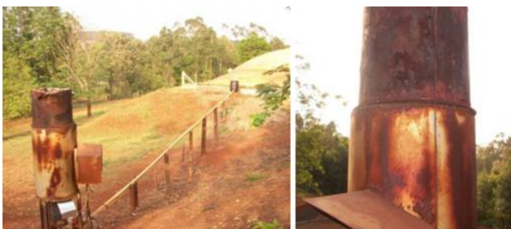
Figura 6: Queimador de Biogás
