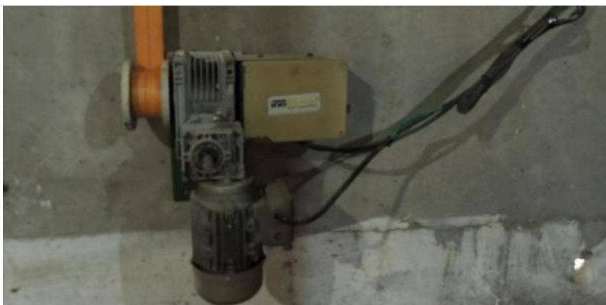
Figura 32: Sistema de ventilação túnel door . Máquina de abertura de entrada de ar.
