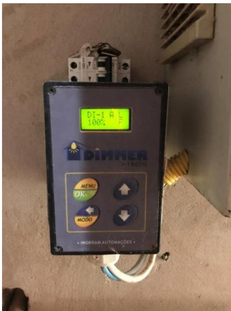
Figura 53: Sistema de iluminação - Dimmer Inobram I-15000.
