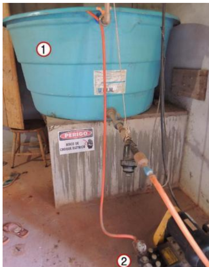
Figura 43: Sistema de abastecimento de água. (1) Reservatório 1.000 litros – nebulizadores e pad cooling (2) Moto-bomba 0,2 cv.
