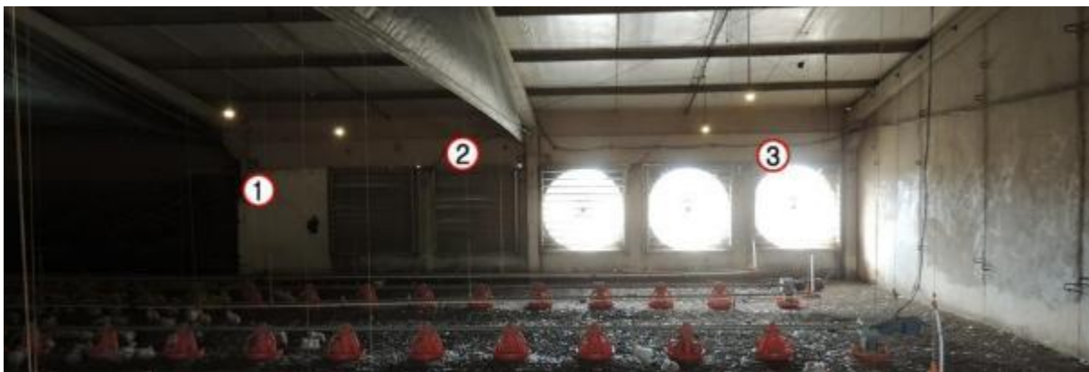
Figura 35: Sistema de ventilação – Exaustores. Face 2 – Vista interna. (1) Espaço destinado a possível implantação de exaustor (2) Exaustores em funcionamento, porém, não ativos (3) Exaustores em funcionamento e ativos.
