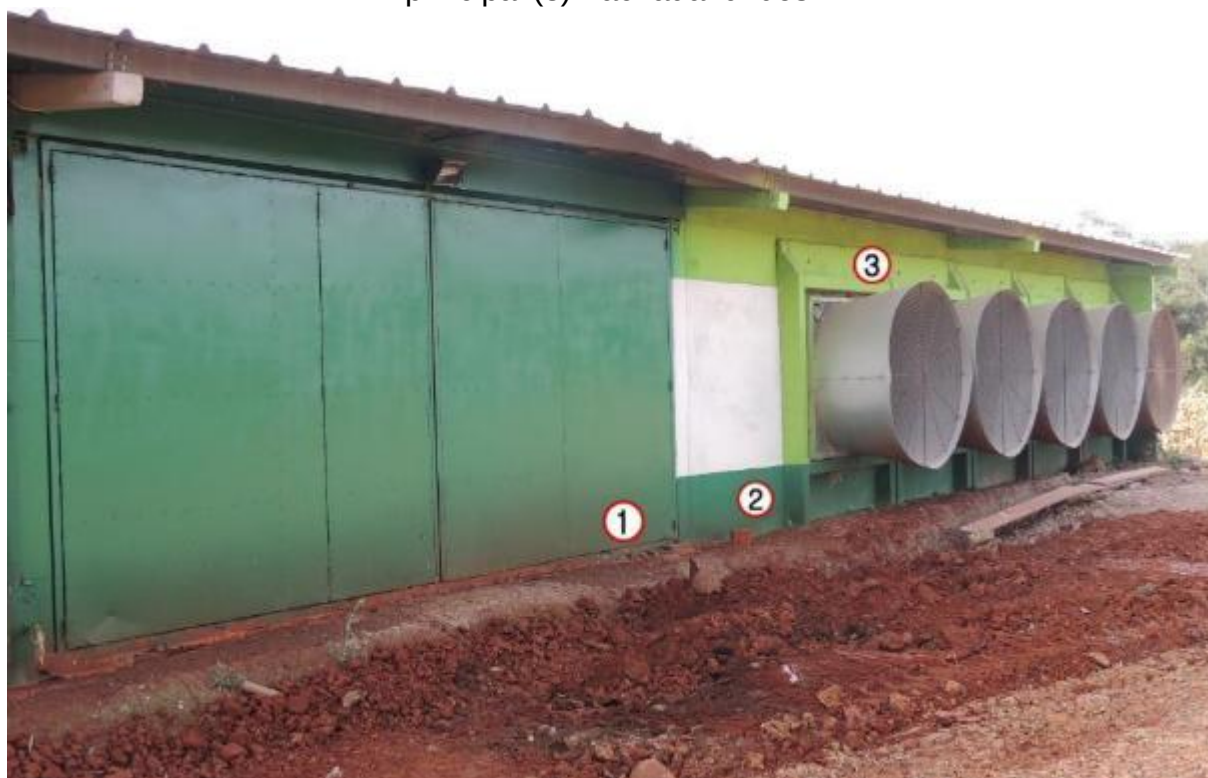
Figura 34: Sistema de ventilação – Exaustores. Face 1 – Vista externa. (1) Porta de acesso lateral (2) Espaço destinado a possível implantação de exaustor (3) Exaustores em funcionamento.
