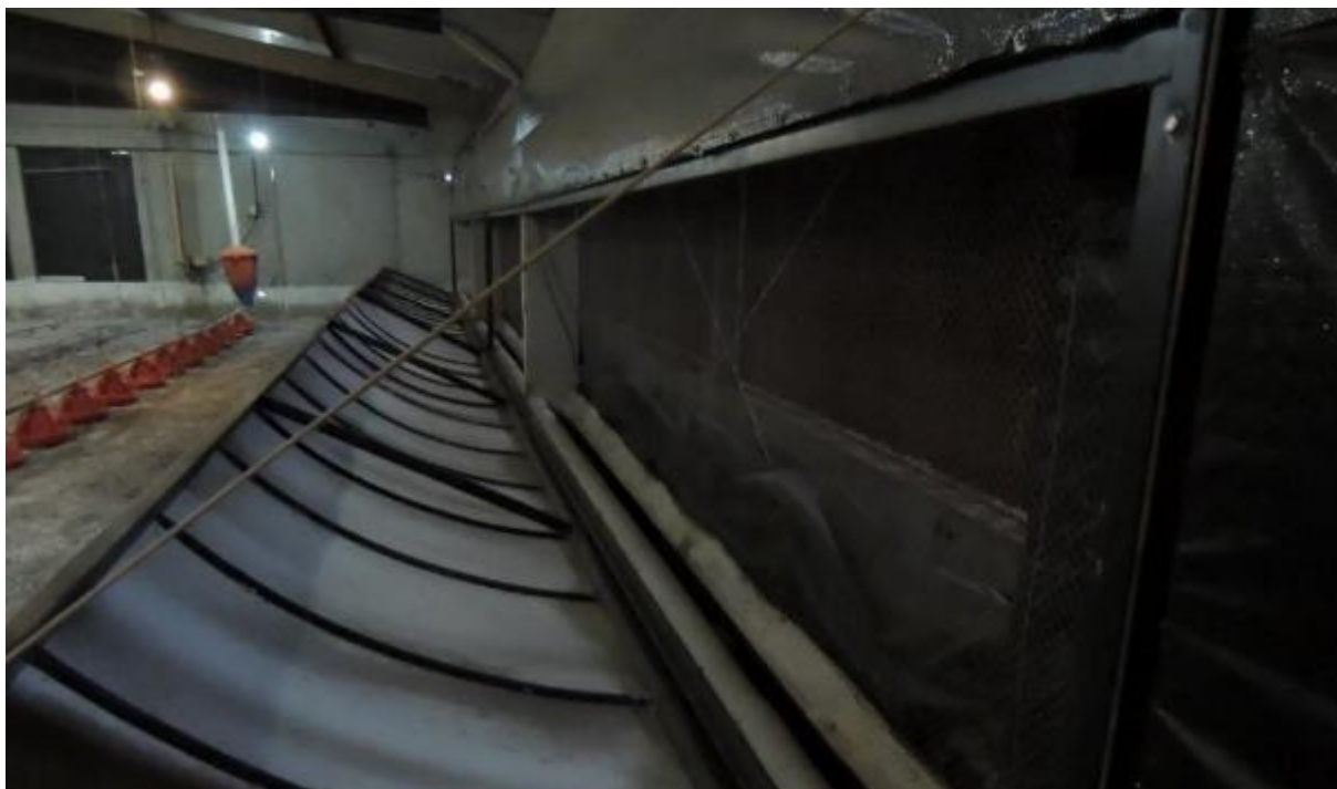
Figura 31: Sistema de ventilação túnel door .
