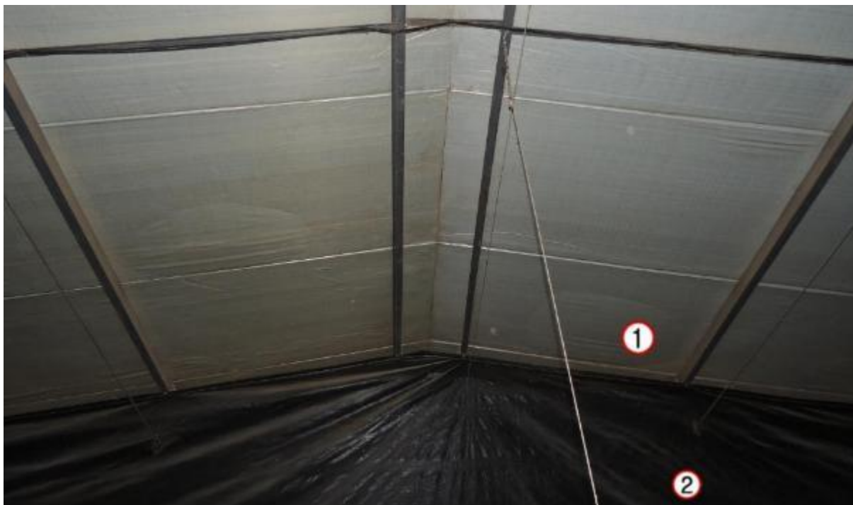
Figura 20: Sistema de cobertura do aviário A1 - telha termoacústica. (1) Camada inferior da telha termoacústica – filme aluminizado (2) Refletor de ar em formato triangular (acompanha a inclinação da cobertura) em lona preta.
