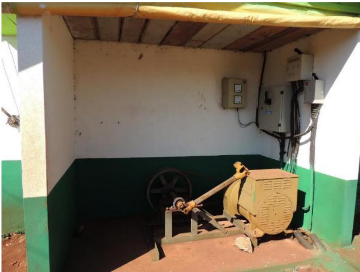
Figura 44: Sistema gerador síncrono da linha New Bei trifásico da marca Nova.
