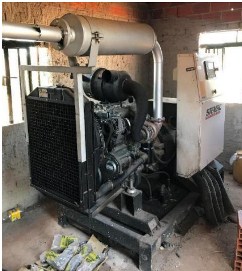
Figura 60: Sistema gerador Stamac.
