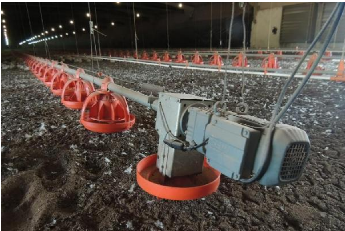
Figura 39: Sistema de nutrição - Comedouro. Conjunto tração/motriz de cada linha de comedouro.
