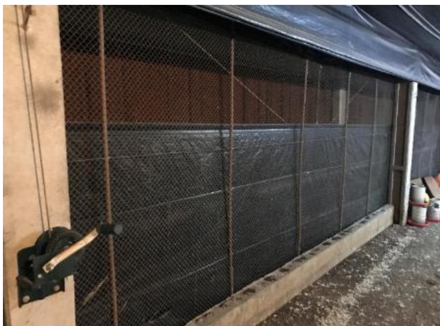
Figura 50: Sistema de resfriamento – Pad cooling com controle de ar realizado com acionamento manual das cortinas.
