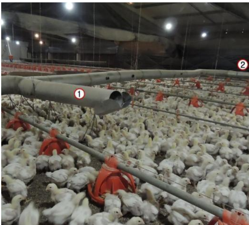
Figura 24: Sistema de aquecimento do aviário A1 – Duto com duas saídas de ar quente. (1) Saída 1 (2) Saída 2.
