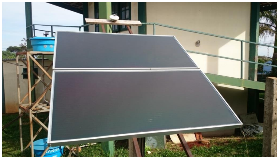
Figura 13. Painel fotovoltaico de silício amorfo instalado.
