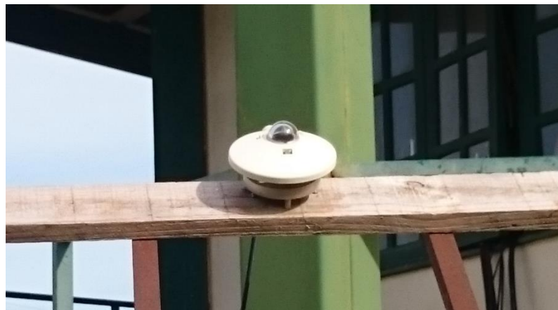
Figura 17. Piranômetro CMP3 instalado no plano do painel.
