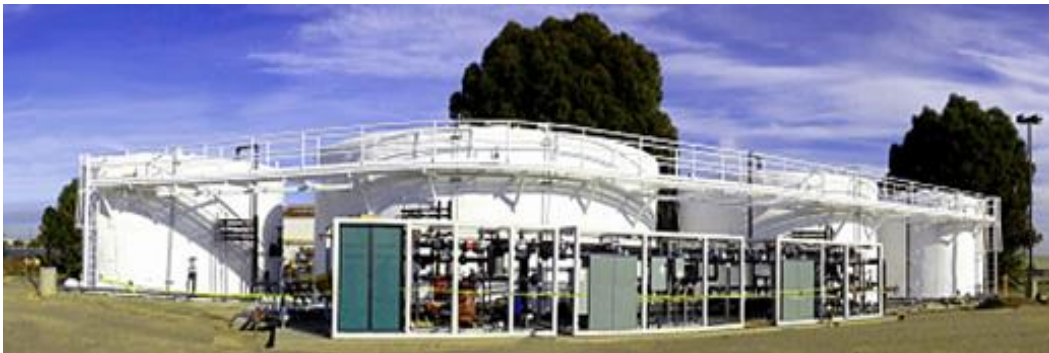
FIGURA 11 - Usina de Biodigestão de Sacramento, Califórnia, EUA.
