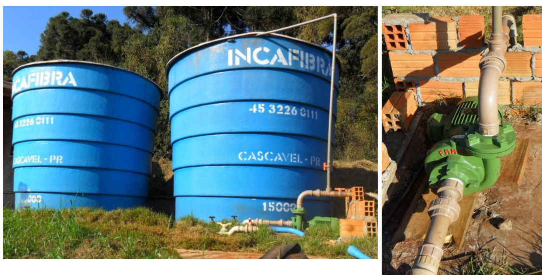
Figura 2 Reservatórios e sistema moto-bomba da área experimental
