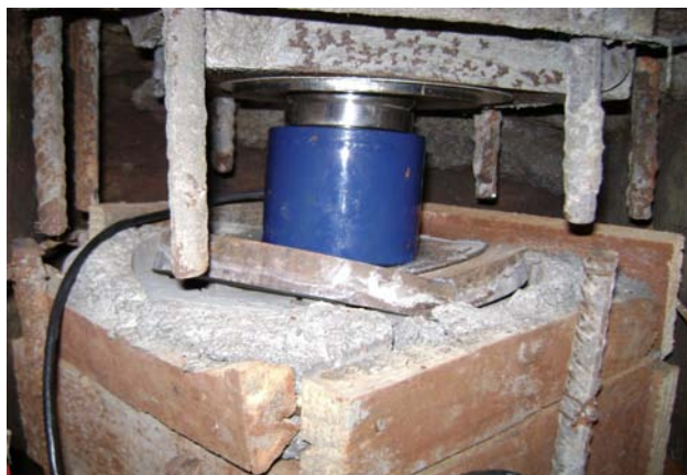
Figura 39 Rompimento da base de regularização de suporte da célula de carga.
